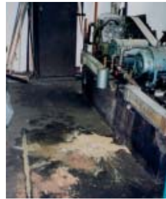
MKW-Verunreinigung des Bodens an einem Kompressorstandort
