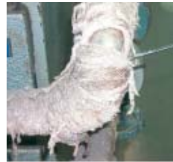
Rohrisolierung mit Asbestschnüren
