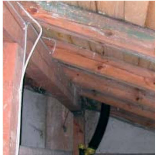
Dachstuhl mit Verdacht auf Holzschutzmittel
