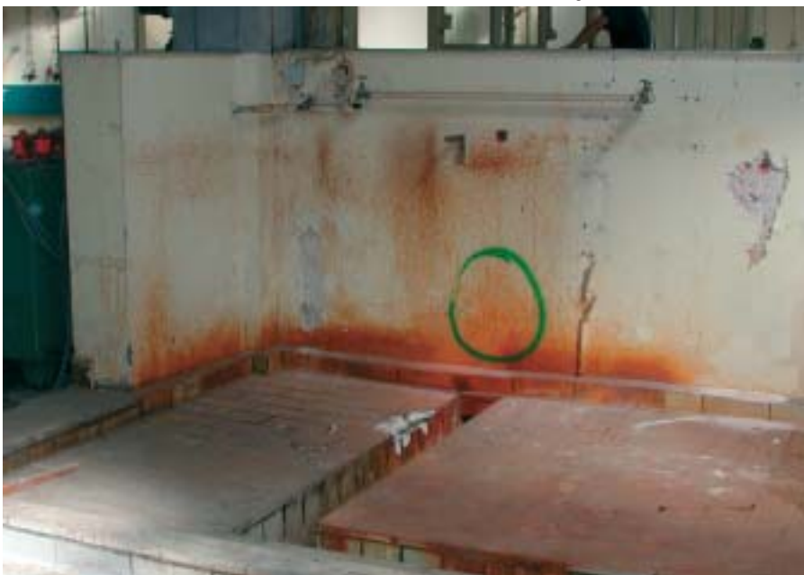
Nutzungsbedingte Kontamination in einer ehemaligen Galvanik
