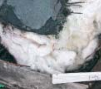
Dachaufbau mit weißer KMF-Wolle
