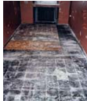
Schwarzkleber unter dem Fußbodenbelag
