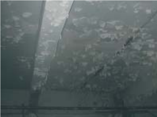
Decke mit abplatzender Farbe
