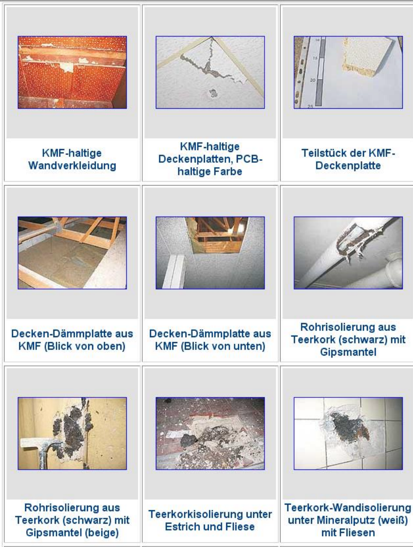
Abb. 5: Fototafel im Schadstoffratgeber Gebäuderückbau
