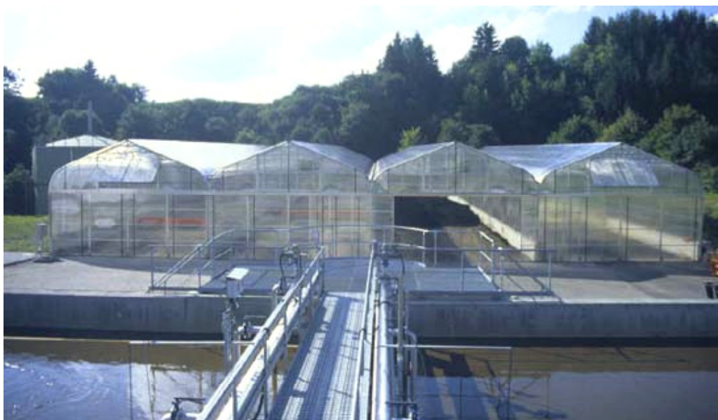
Abb. 2: Außenansicht der solaren Klärschlamm-trocknungsanlage Füssen-Ehrwang [2]
